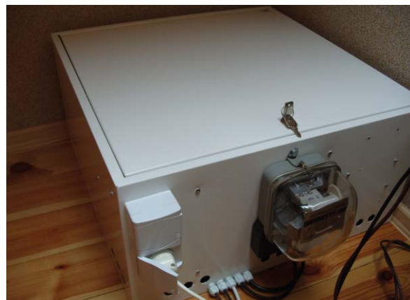
Fotografia 10. Urządzenie zamknięte w obudowie
