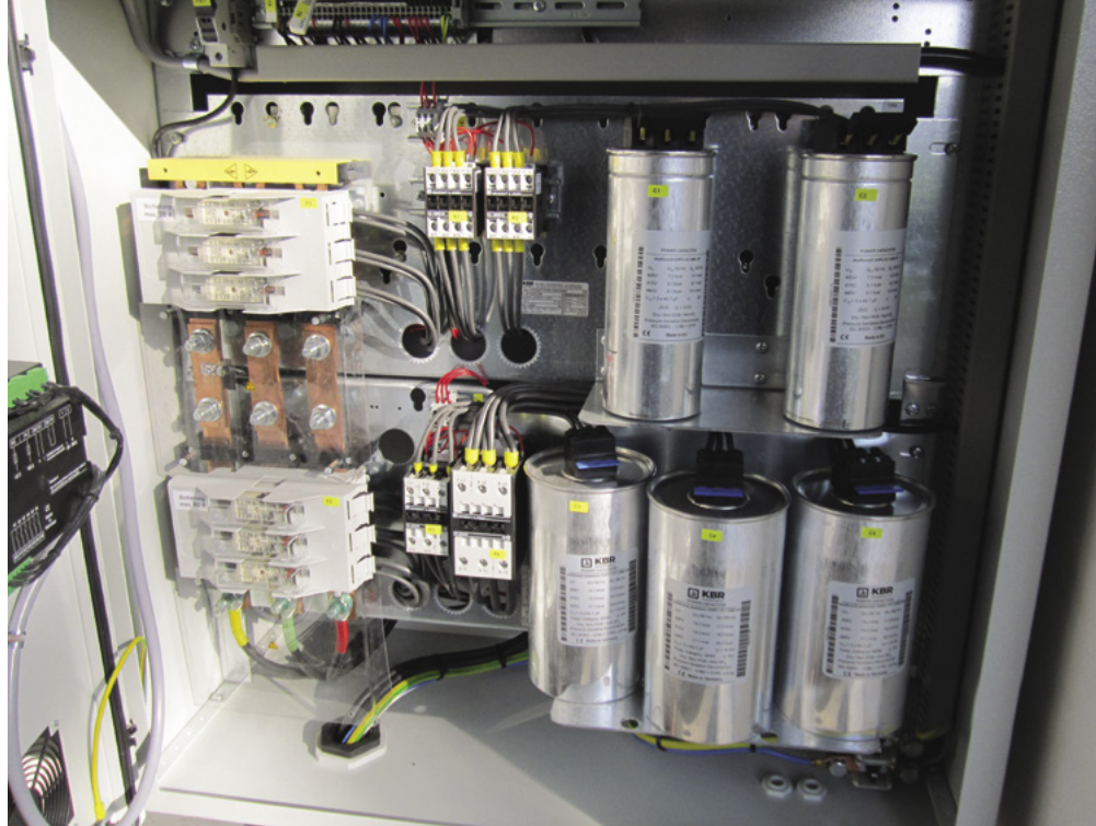
Fotografia 2. Przykładowa bateria kondensatorów służąca do kompensacji mocy biernej
